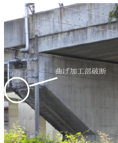
写真2.1 曲げ加工部の破断箇所 (梁部)
