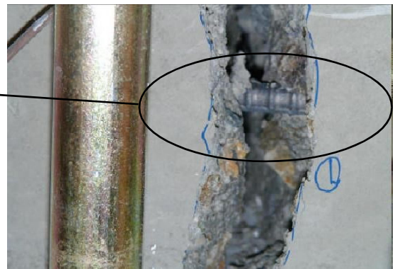
(4) 左図の場所を側面から観察 (せん断補強筋の直線部の確認)
