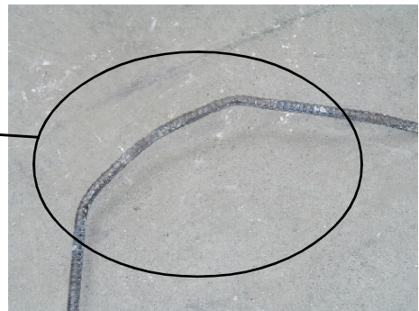
(8) 曲げ加工部の変形が激しい箇所
