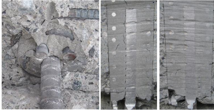
左側端部 継手の損傷 左側端部 右側端部
