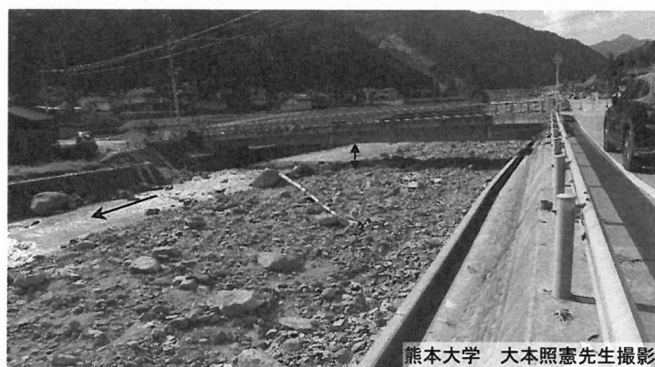
図-2.6 花月川名徳橋付近の河道内土砂堆積の状況
